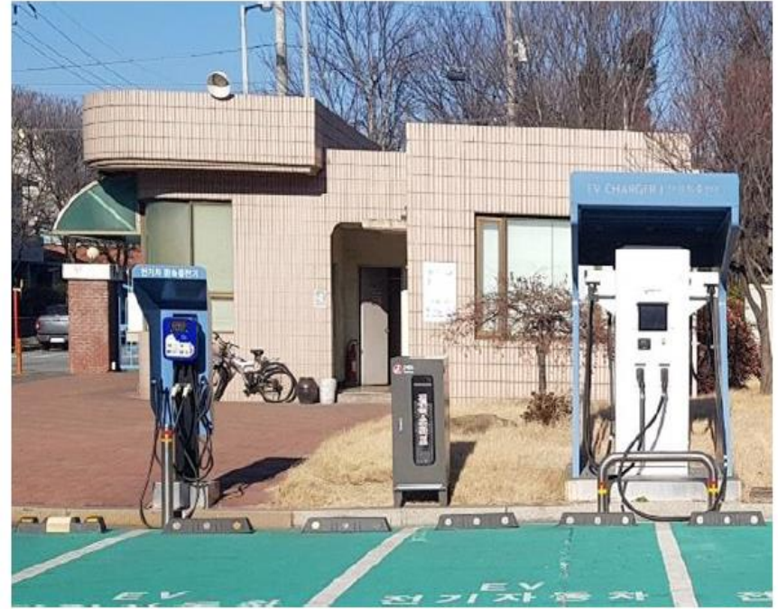
[포항업체 S社 1set 설치]
