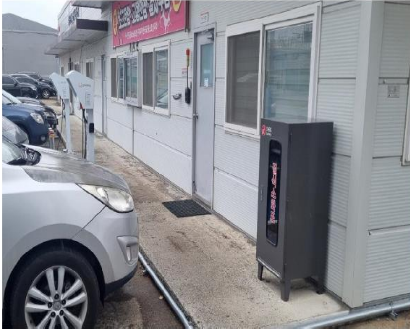
[김천업체 O社 1set 설치]
